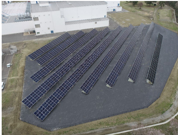
いわき工場内に設置した太陽光発電システム
